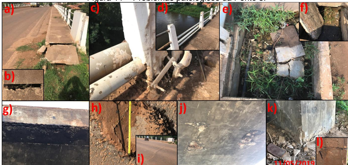
Figura 11 – Problemas patológicos da Ponte 5.
