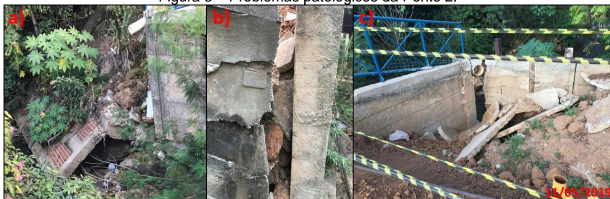
Figura 8 – Problemas patológicos da Ponte 2.
