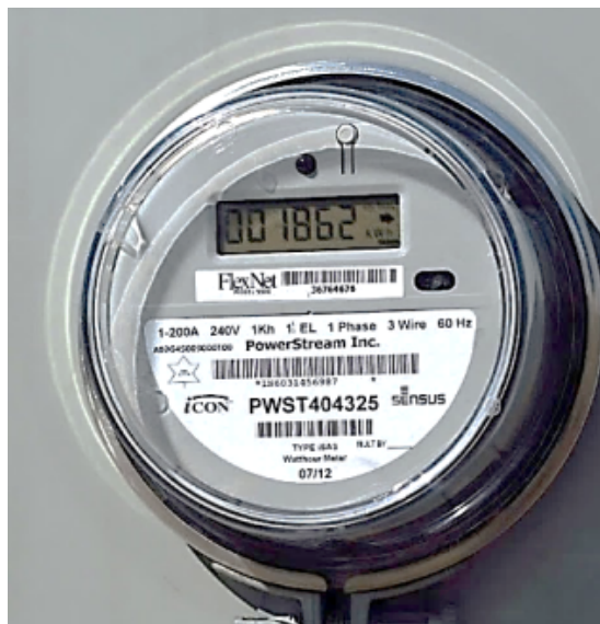
Figura 2.1: Medidor de Energia utilizado no Exemplo 1
